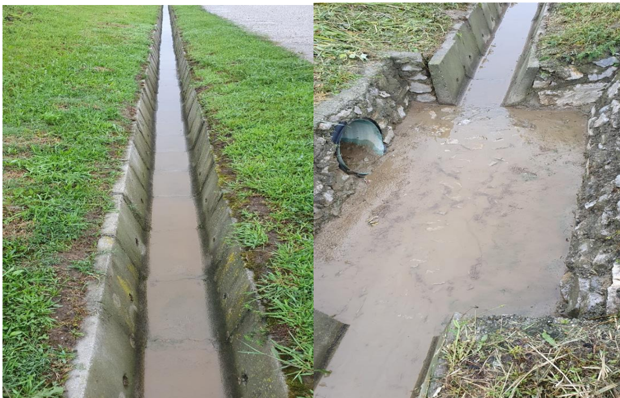
Stanje obodnog kanala oko tijela odlagališta – 04.08.2020.
